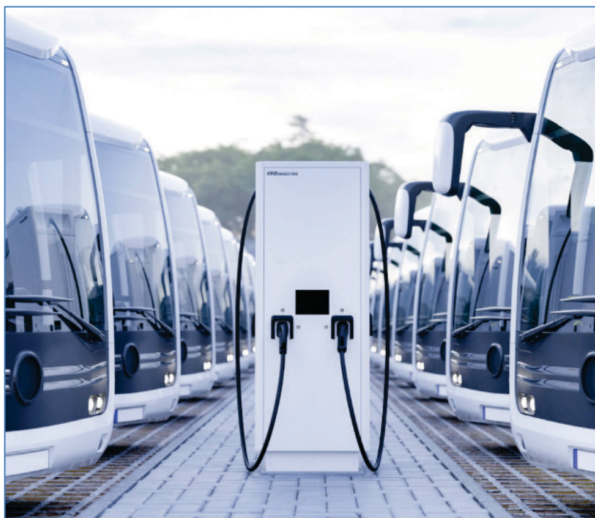
Obrázek 17 dobíjecí stanice s distribuovaným řízením dobíjecího výkonu ZDROJ: ČEZ ESKO a.s.
