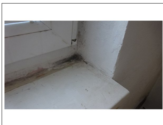
Byt pro sportovce, pokoj - plísň okolo rámu oken.
