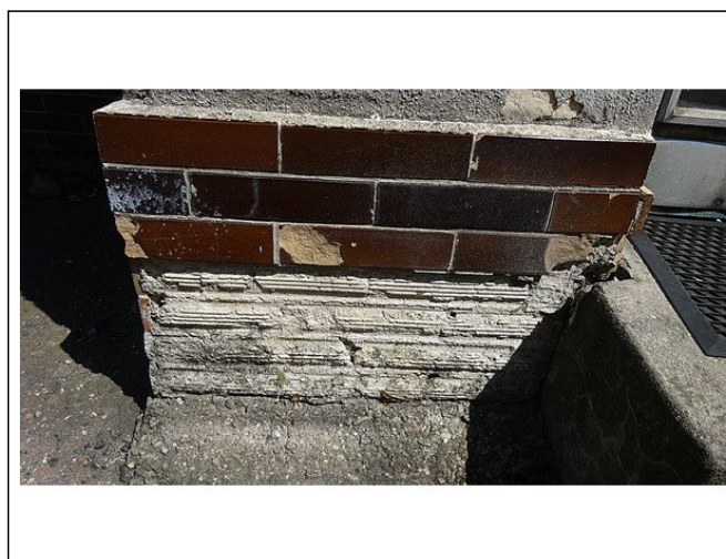
Uvolnění a opadávání obkladu soklové části.
