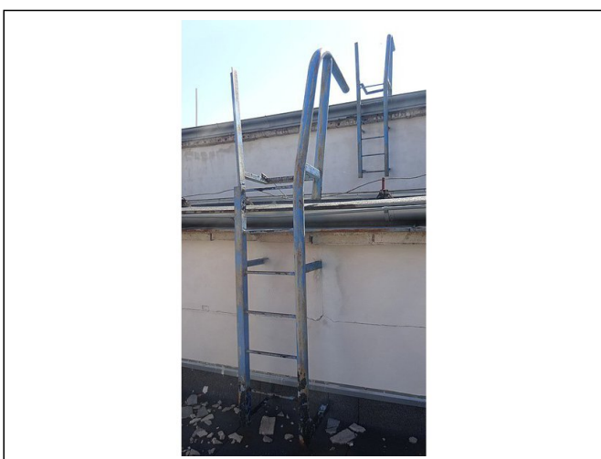
F) SPORTOVNÍ HALA - Koroze přístupových žebříků.
