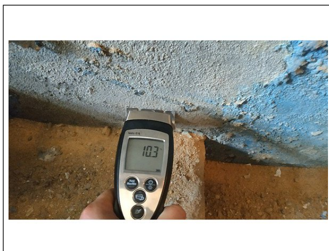
Tyršův dům, sklep - naměřená vysoká hmotnostní vlhkost stěny 10,3%.
