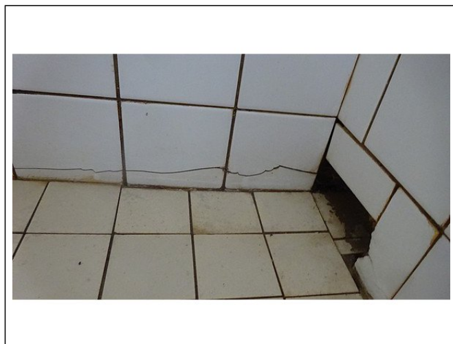
Obklady a dlažba nezrekonstruovaných umýváren u šaten sportovců - sportovní hala.
