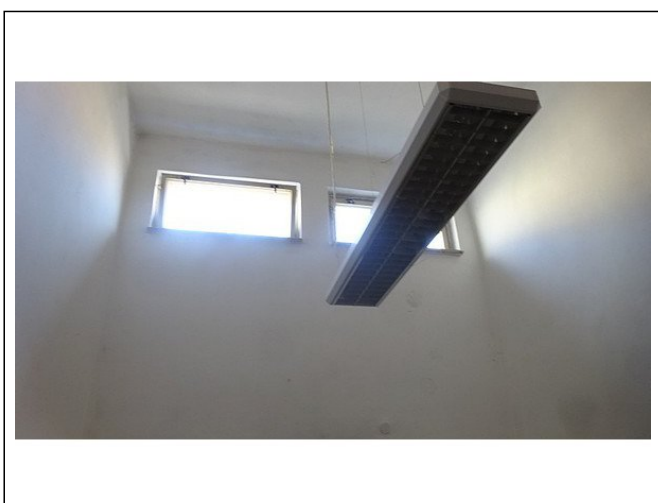
Absence ventilátoru a neumožněné otvírání oken v umývárkách u šaten - tvorba plísní.
