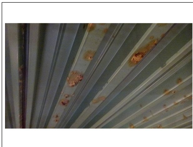
F) SPORTOVNÍ HALA - Koroze spodní části trapézových plechů pohledu střešní konstrukce.
