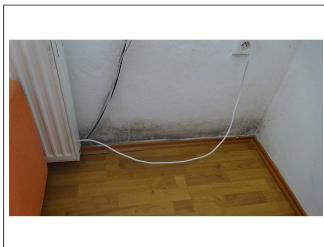
Byt pro sportovce - plísň v dolním rohu.
