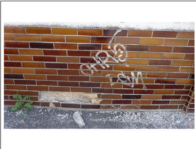
Uvolnění a opadávání obkladu soklové části.
