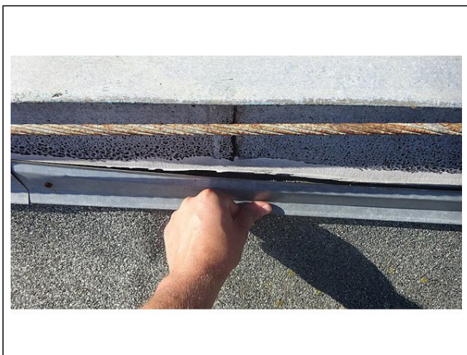
F) SPORTOVNÍ HALA - Poškozené napojení povlakové hydroizolace a oplechování na stěny atiky, riziko zatékání.
