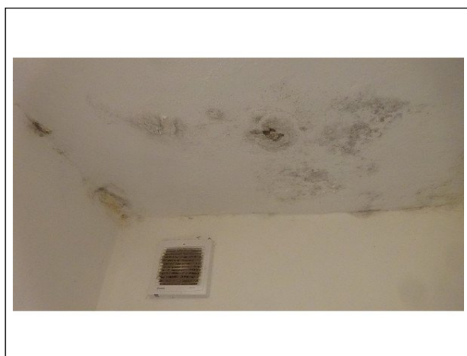
Byt pro sportovce, koupelna - plísně v horním koutu a na stropě.
