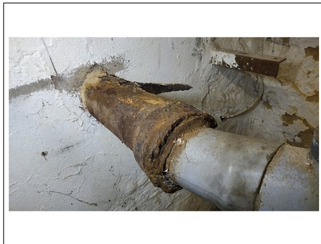
Rozsáhlá koroze, netěsnost kanalizace - sklep, Tyršův dům.
