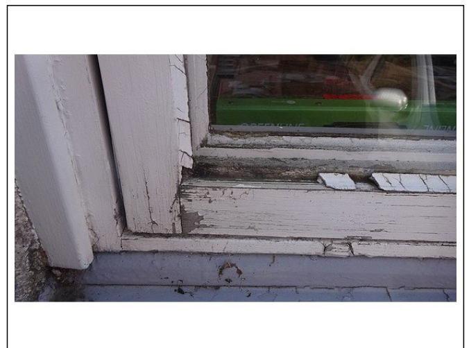
Původní dřevěné okno, vypadávání tmelu zasklení.
