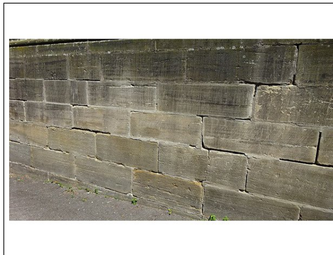
Vypadávání spárovací hmoty, lokální drobení pískovce.
