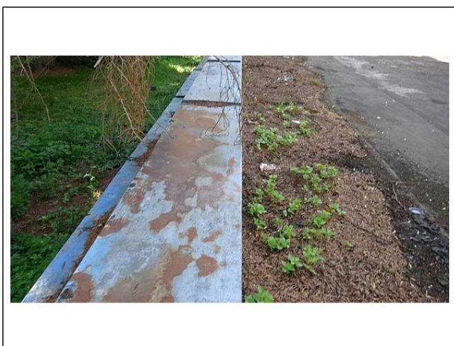
G) GARÁŽ - Koroze oplechování atiky.
