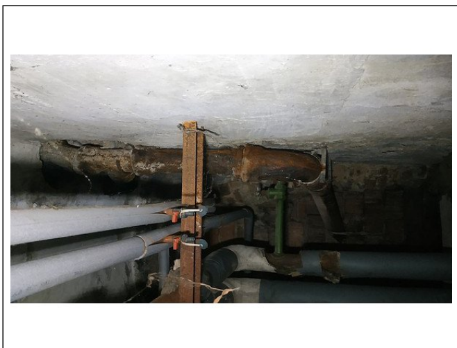
Koroze kovových TZB rozvodů.
