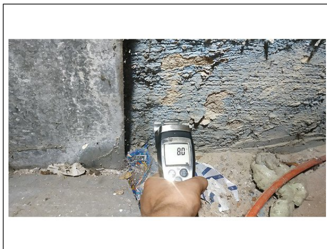
Tyršův dům, sklep - naměřená mírně zvýšená hmotnostní vlhkost stěny 8,0%.
