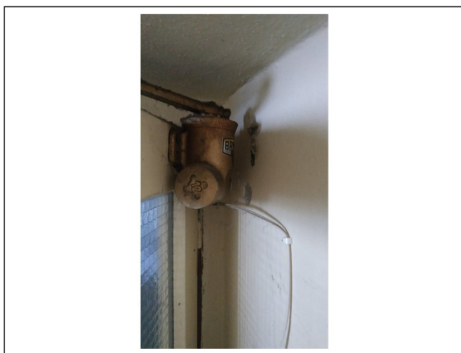
Narážení zavírače dveří do stěny - chodba Tyršův dům.
