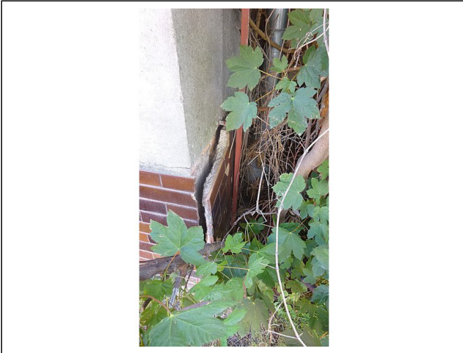
Uvolnění a opadávání obkladu soklové části.
