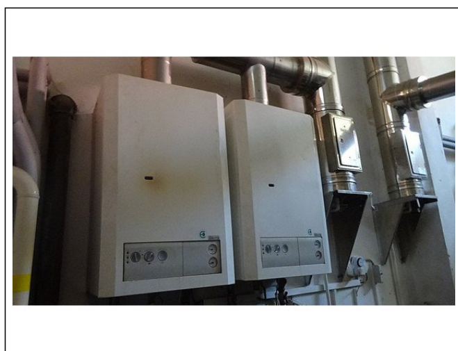
Plynové kotle - Sportovní hala.
