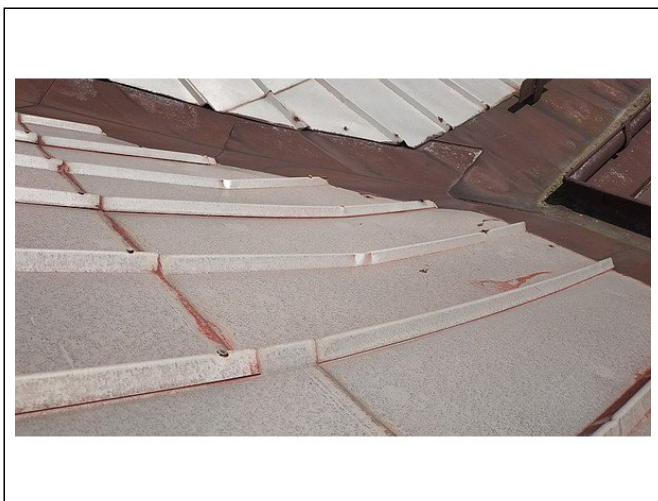
Koroze a absence středového ohybu v úžlabí oplechování - riziko zatékání pod krytinu.
