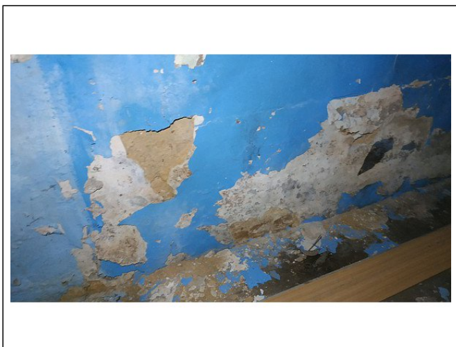
Tyršův dům, sklep - masivní opadávání omítky.
