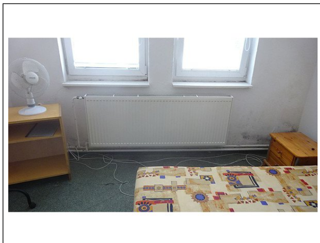
Plísně za nábytkem - byt pro sportovce.
