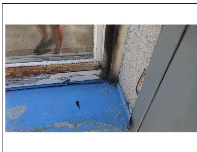
Mezera mezi ostěním a parapetem.
