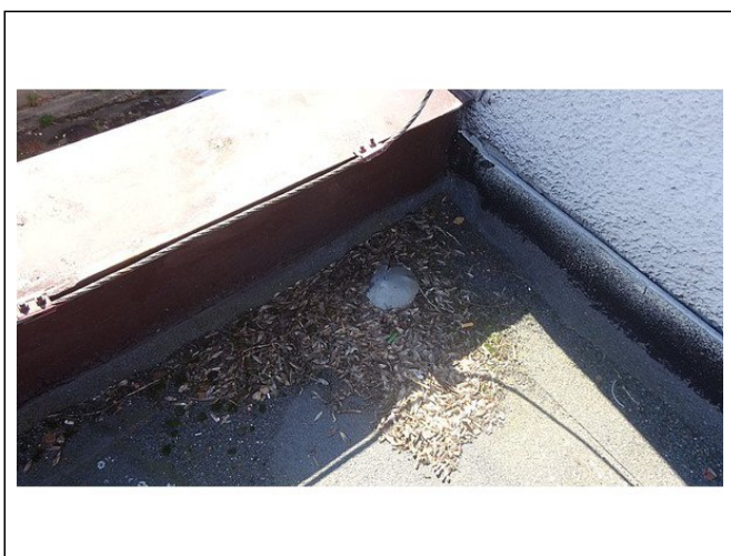
A) VSTUPNÍ HALA - Zbytky listí v rozích střechy.
