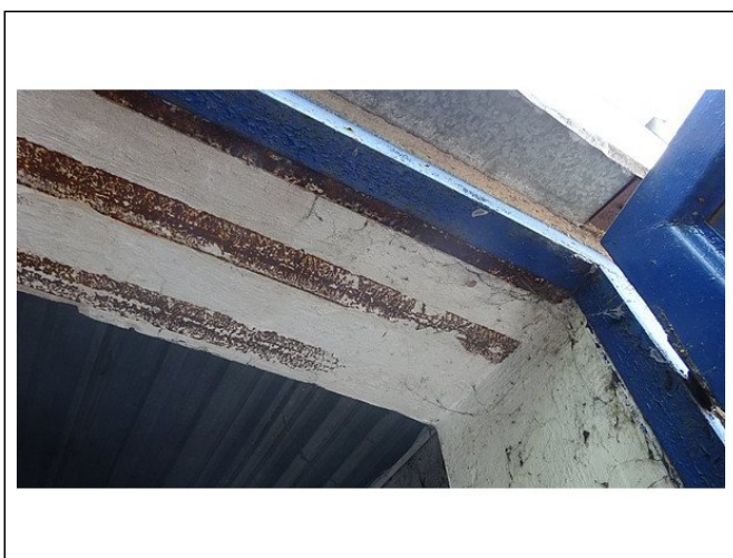
Opadávání omítky a koroze ocelového překladu u vrat.
