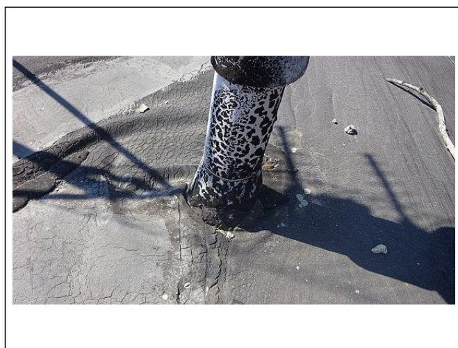
E) ŠATNY + UMÝVÁRNY - Netěsný vstup potrubí.
