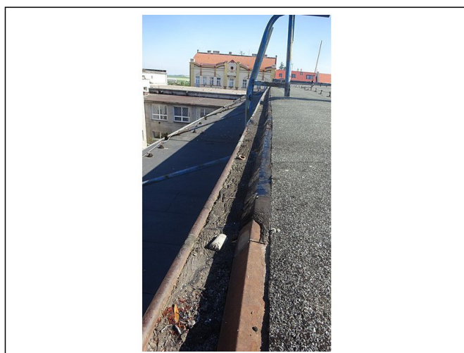
F) SPORTOVNÍ HALA - Dešťový okap plný rozpuštěného asfaltu.
