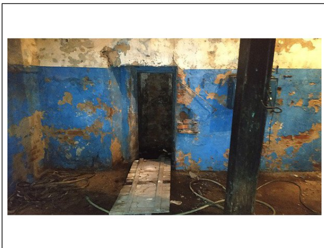
Místo tvorby kaluží ve sklepě.
