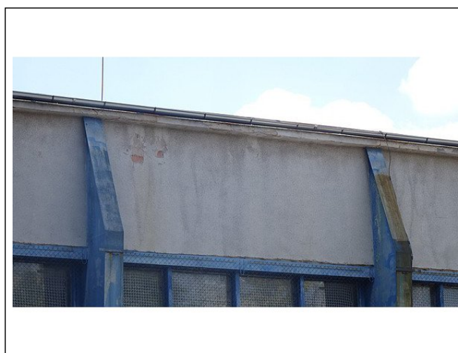
Oprýskání barvy a koroze konstrukce sportovní haly.
