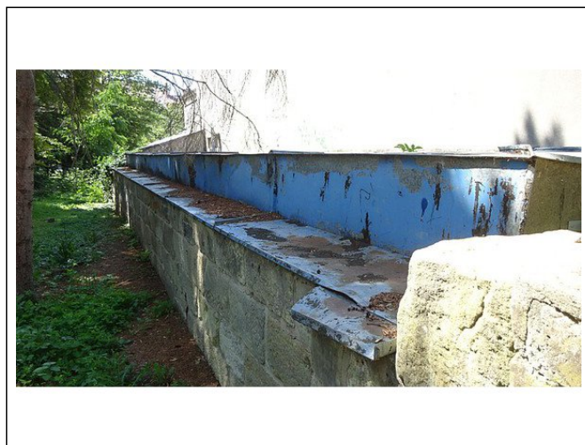
Růst dřevin po fasádě, střeše - pohled z parku.
