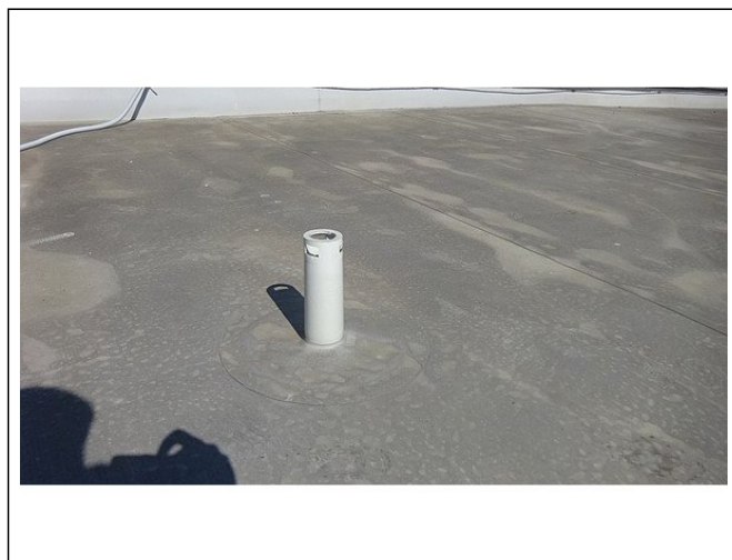
C) MALÁ TĚLOCVIČNA - Odpadnutí vrcholové stříšky potrubí.
