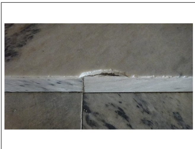
Vstupní hala schodiště sportovní haly - rozbití vnitřní dlažby.
