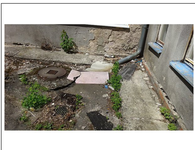
Pohled na přední stěna sportovní haly ze dvora - nevhodné ukončení hydroizolace spodní stavby + absence odvodnění dešťové vody.
