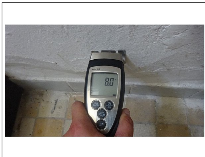
1. NP. schodiště do bytu pro hráče - naměřená vysoká hmotnostní vlhkost stěny 8,0%.
