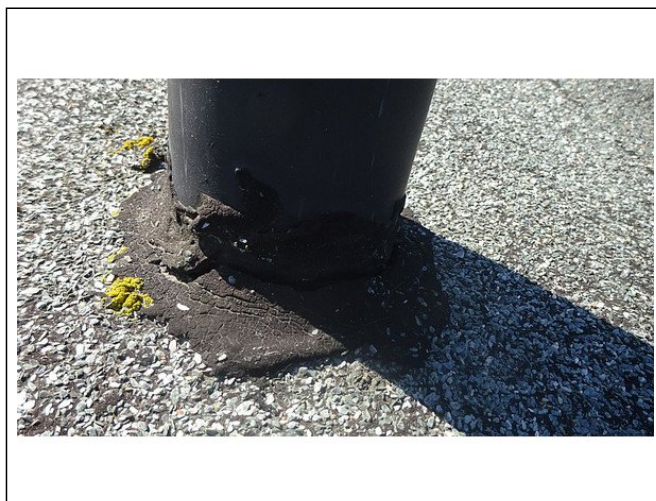
F) SPORTOVNÍ HALA - Lokální netěsné napojení u prostupu potrubí.
