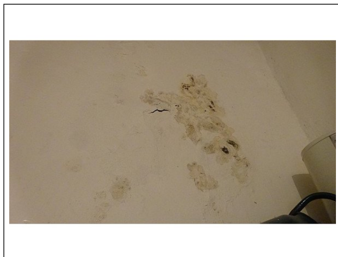
Kuchyně bufetu - plíseň na stěně.
