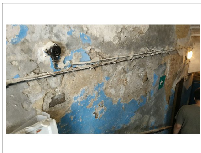
Tyršov dům, sklep - schodiště - masivní opadávání omítky.
