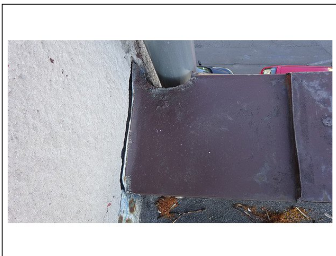
A) VSTUPNÍ HALA - Nevhodné napojení oplechování atiky na stěnu.
