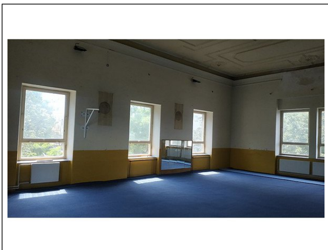
Absence otopných těles pod některými okny - Tyršův dům, gymnastický sál.
