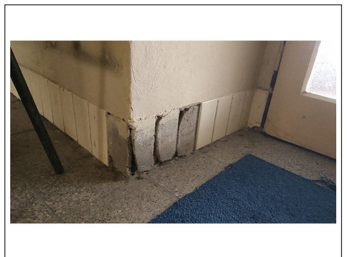
Tyršův dům - opadávání vnitřních soklových obkladů.
