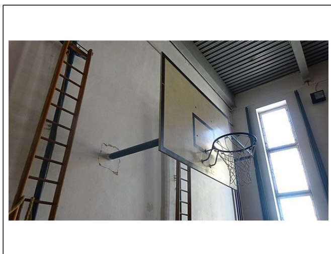
Trhlina ve spoji dvou rozdílných materiálů.
