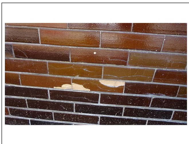
Uvolnění a opadávání obkladu soklové části.
