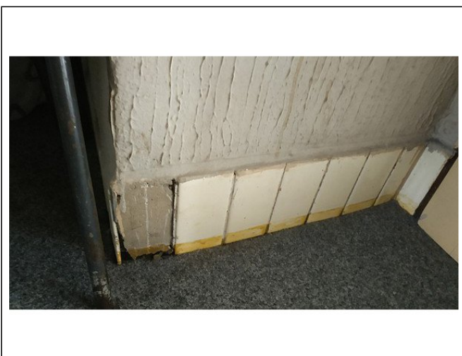
Tyršův dům - opadávání vnitřních soklových obkladů.
