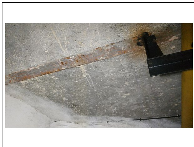
Koroze stropních ocelových I nosníků.
