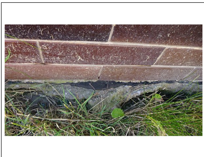
Severní stěna sportovní haly - nevhodné ukončení hydroizolace spodní stavby.
