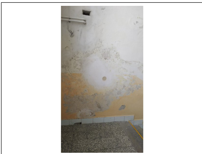
Tyršov dům, schodiště 1.NP. - opadávání omítky vlivem zvýšené vztlínající vlhkosti.
