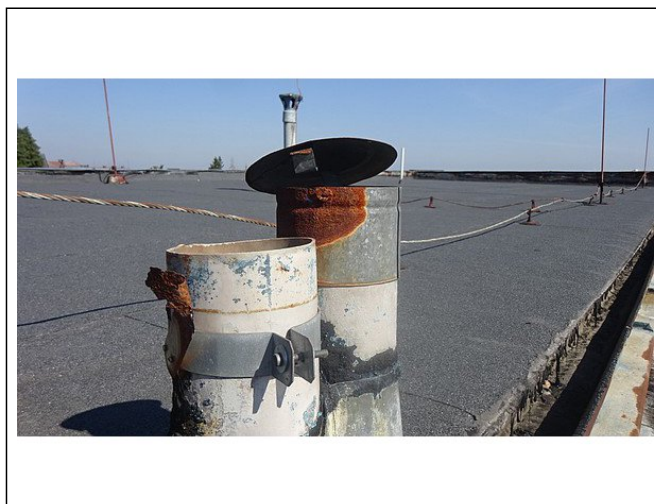
B) HOTEL - Odpadnutí vrcholové stříšky potrubí.
