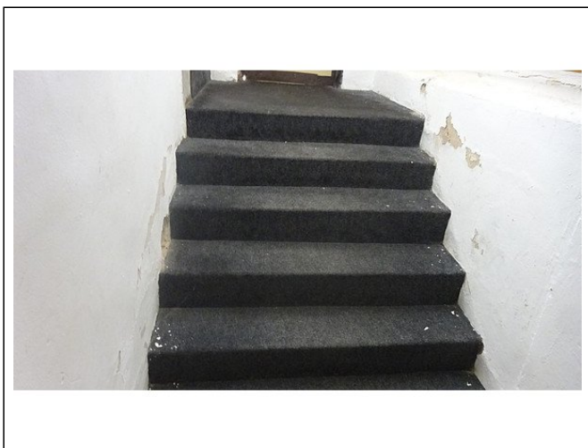
1. NP. schodiště do bytu pro hráče, opadávání omítky.
