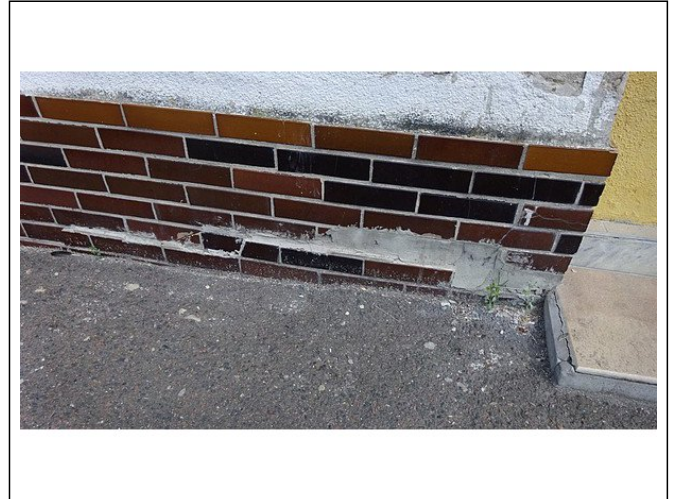
Uvolnění a opadávání obkladu soklové části.
