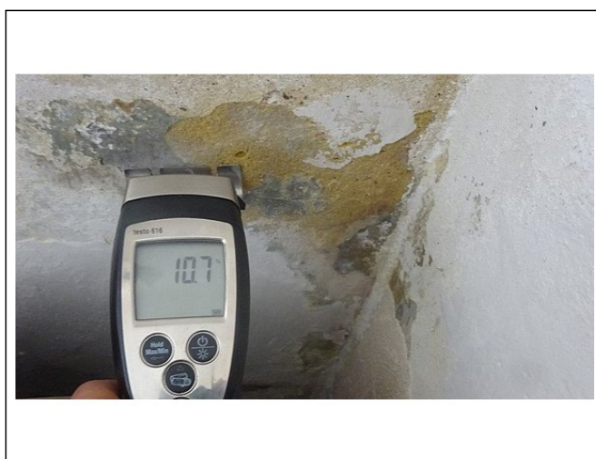
1. NP. kancelář správce - naměřená vysoká hmotnostní vlhkost stěny 10,7%.
