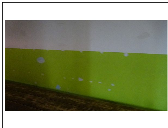
Mechanické poškození, opadávání, oškrábání omítky - chodba u šaten sportovní haly.
