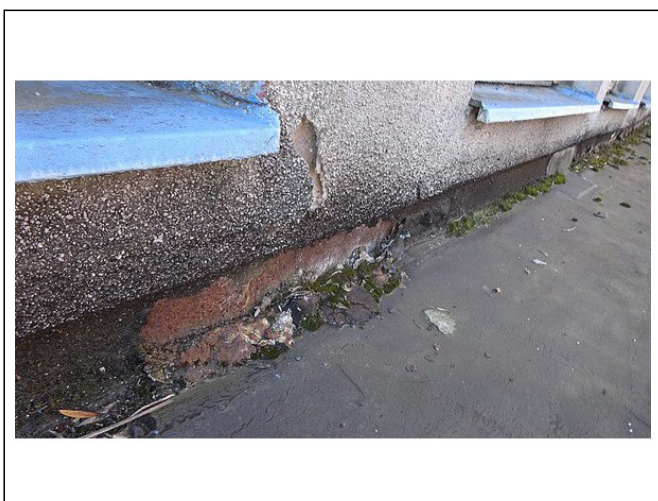
E) ŠATNY + UMÝVÁRNY - Poškozené napojení povlakové hydroizolace na stěny, riziko zatékání.
