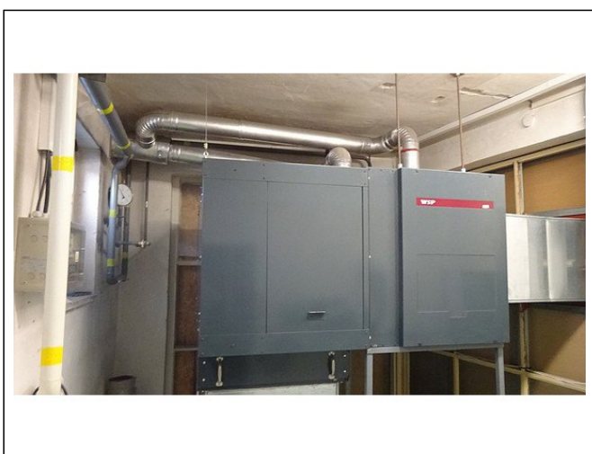
Plynový teplovzdušný agregát - Sportovní hala.
