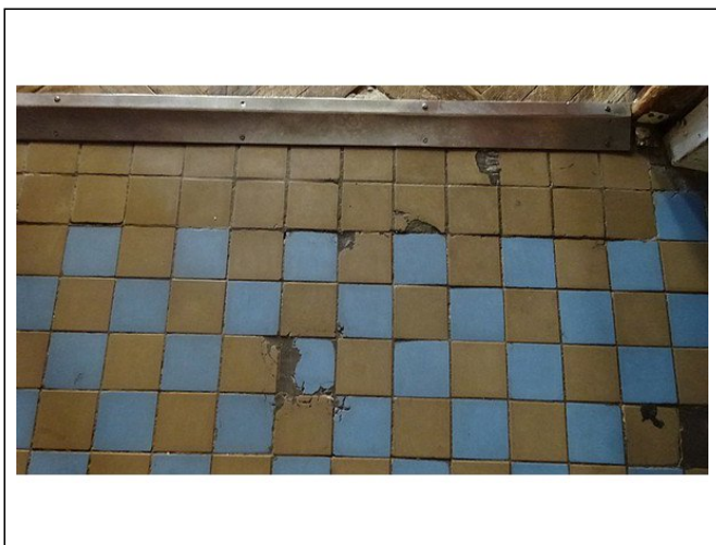
Chodba sportovní haly - rozbití vnitřní dlažby.
