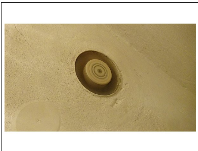
Absence zakrytování ventilátoru na WC - hotel.
