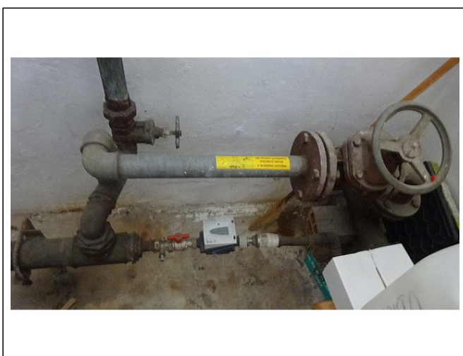
Vodoměr - Sportovní hala.
