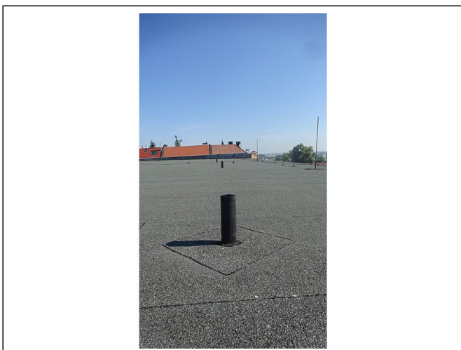
F) SPORTOVNÍ HALA - Odpadnutí vrcholové stříšky potrubí.
