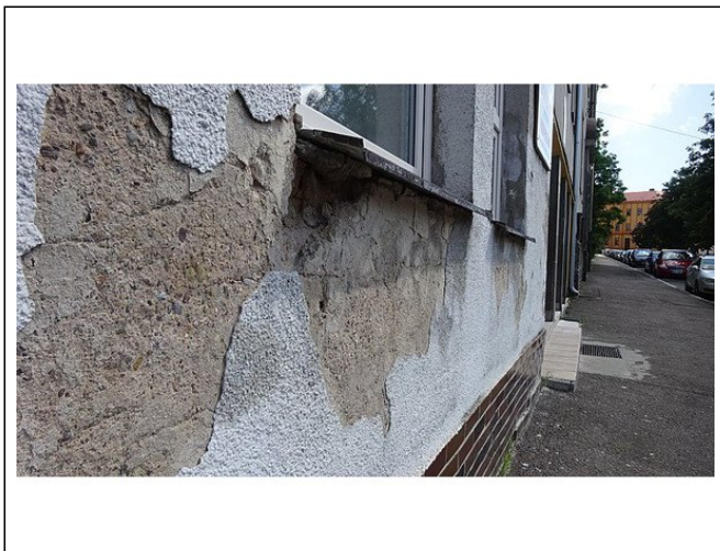
Tvorba puchýřů a odpadávání břizolitové omítky.
