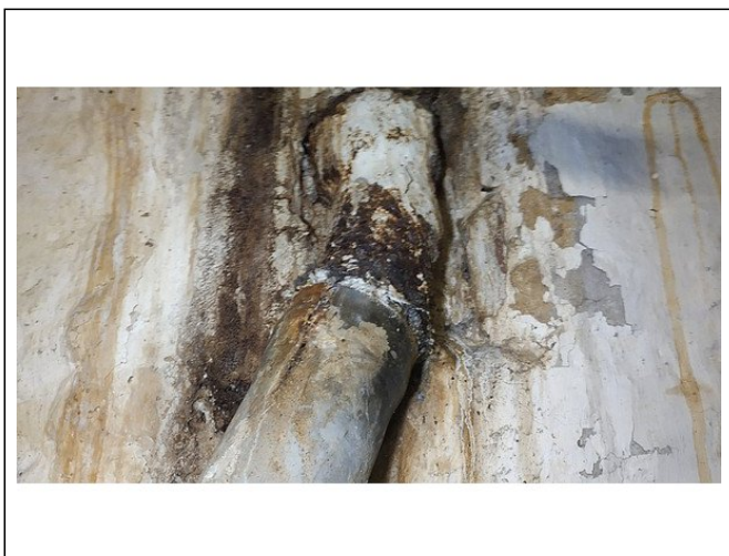
Rozsáhlá koroze, netěsnost kanalizace - sklep, Tyršův dům.
