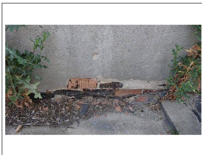
Zadní stěna sportovní haly - nevhodné ukončení hydroizolace spodní stavby.
