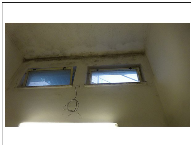
Absence ventilátoru a neumožněné otvírání oken v umývárkách u šaten - tvorba plísní.
