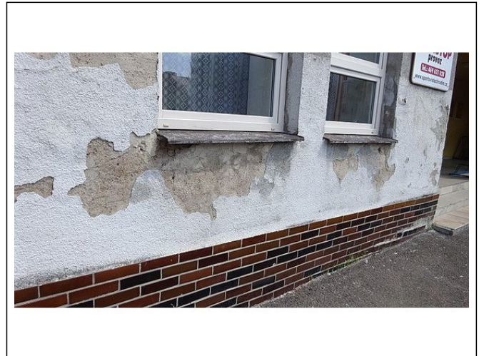
Opadávání omítky vlivem vztlínající vlhkosti.
