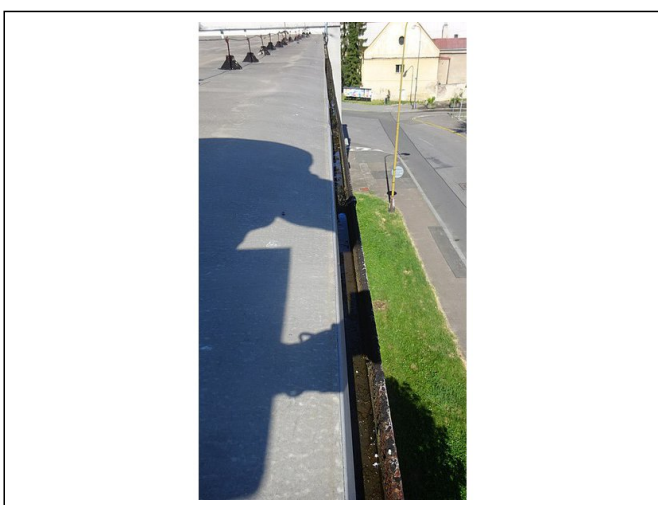
C) MALÁ TĚLOCVIČNA - Zanesený okapový žlab asfaltem.
