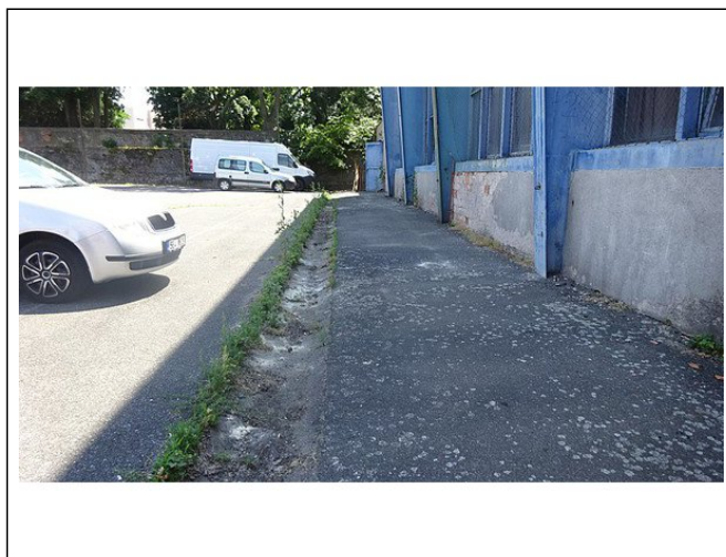
Pohled na zadní stěna sportovní haly - nevhodné ukončení hydroizolace spodní stavby.
