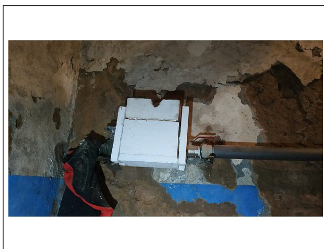
Vodoměr - Tyršův dům.
