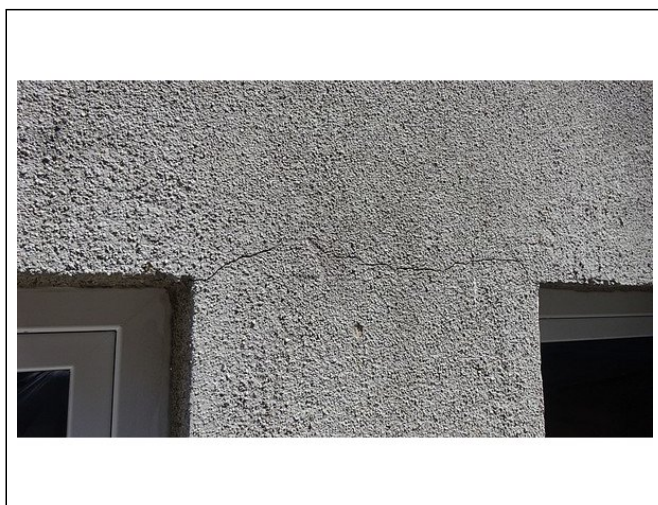
Vodorovná trhlina v místě uložení překladu okna.
