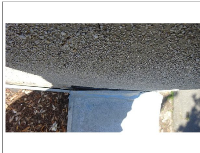
Mezera mezi napojení oplechování ploché střechy na stěnu.
