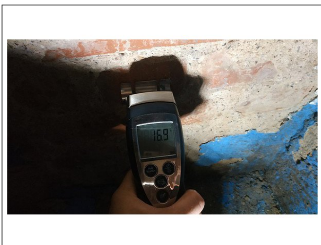
Tyršův dům, sklep - naměřená velmi vysoká hmotnostní vlhkost stěny 16,9%.
