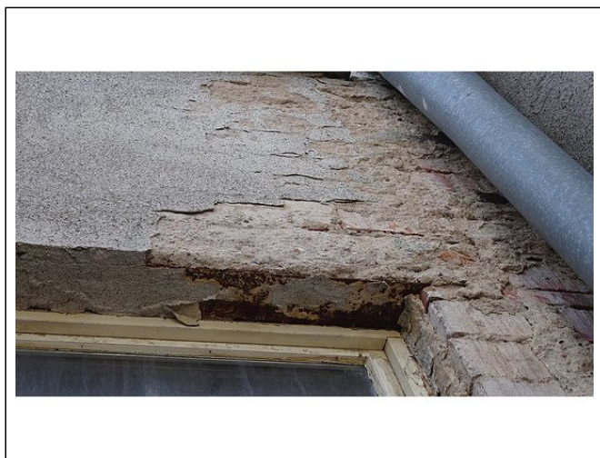
Opadávání omítky a koroze ocelového překladu u okna.
