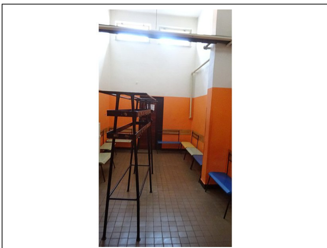
Neumožněné otvírání oken (jsou vysoko) v šatnách a umývárkách.
