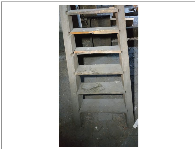
Dřevěné schodiště půda - poškozené stupnice.
