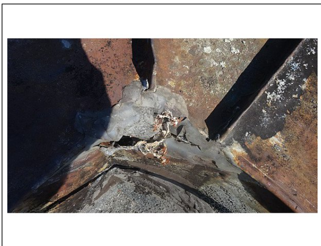
B) HOTEL - Mezera mezi vytažením povlakové hydroizolace na atiku a oplechováním atiky.
