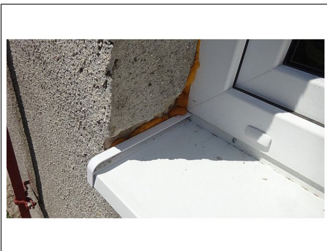
nezapravená montážní pěna okolo okna, parapetu.
