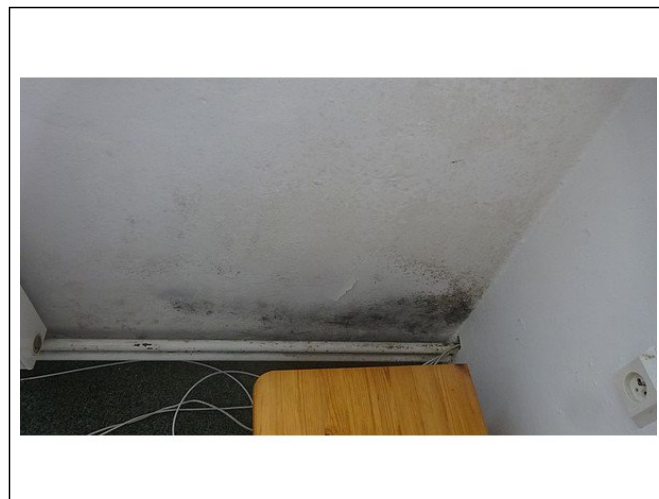
Plísně za nábytkem - byt pro sportovce.
