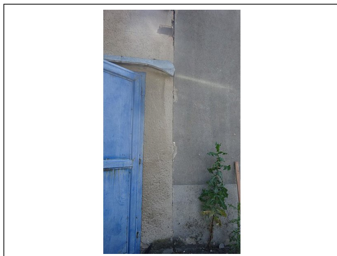
Řasy na fasádě, růst rostlin u fasády - zadní strana sportovní haly.
