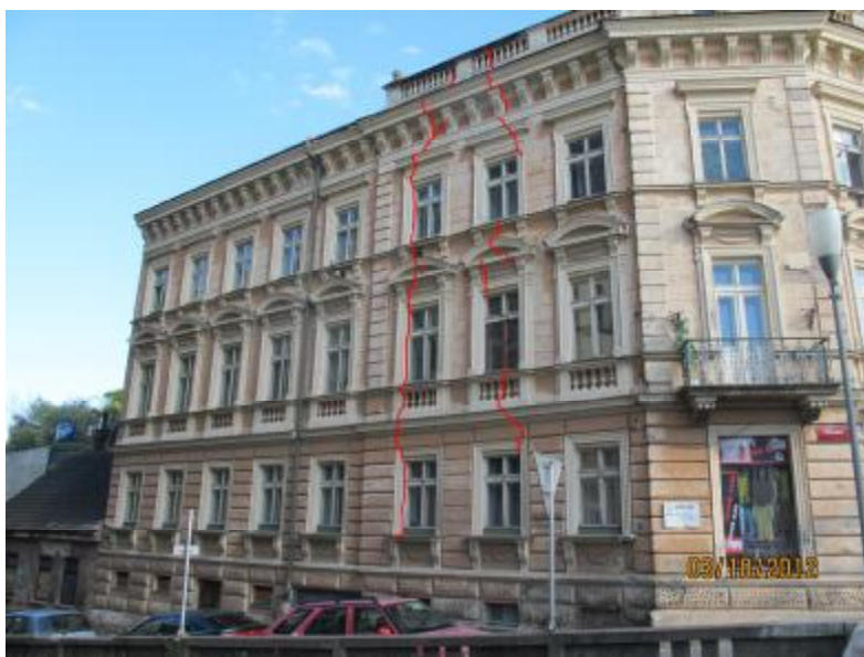
Obr.: průběh trhlin na fasádě směrem k náhonu Chrudimky
